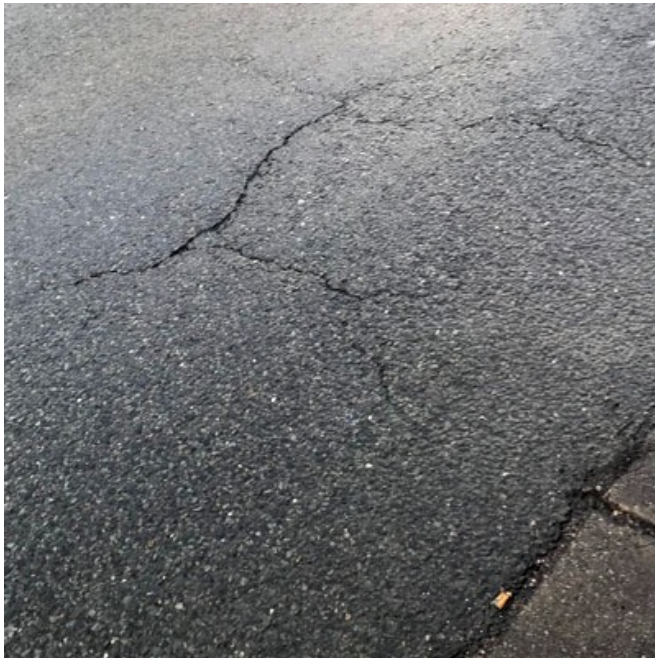
Ex: fissure transverse sur une route
